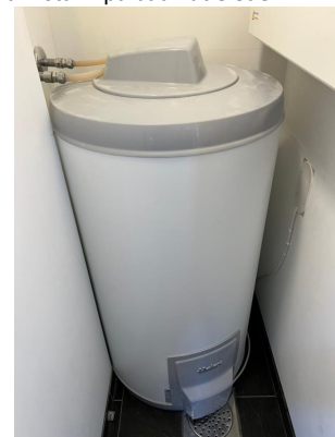
Varmtvannstank i teknisk rom/kott i hoveddel.
