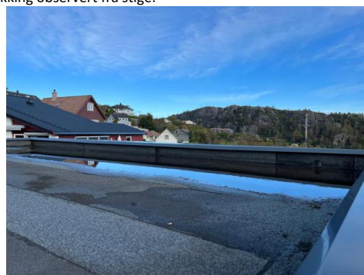
Taktekking observert fra stige. Noe vannansamling observert i ytre del.
