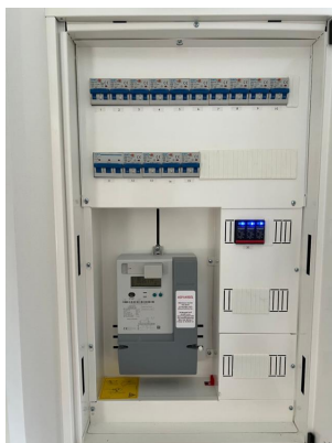
Sikringskap i entre i utleiedel.
