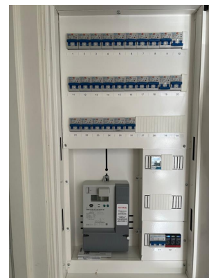
Sikringskap i gang i hoveddel.
