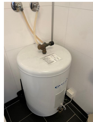
Vegghengt varmtvannstank på bad i utleiedel.
